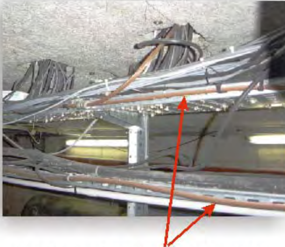
CABLES DE CUIVRE D'ACCOMPAGNEMENT INUTILES
