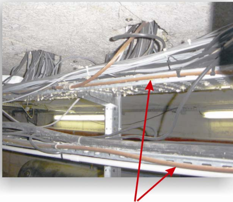
CABLES DE CUIVRE D'ACCOMPAGNEMENT INUTILES
