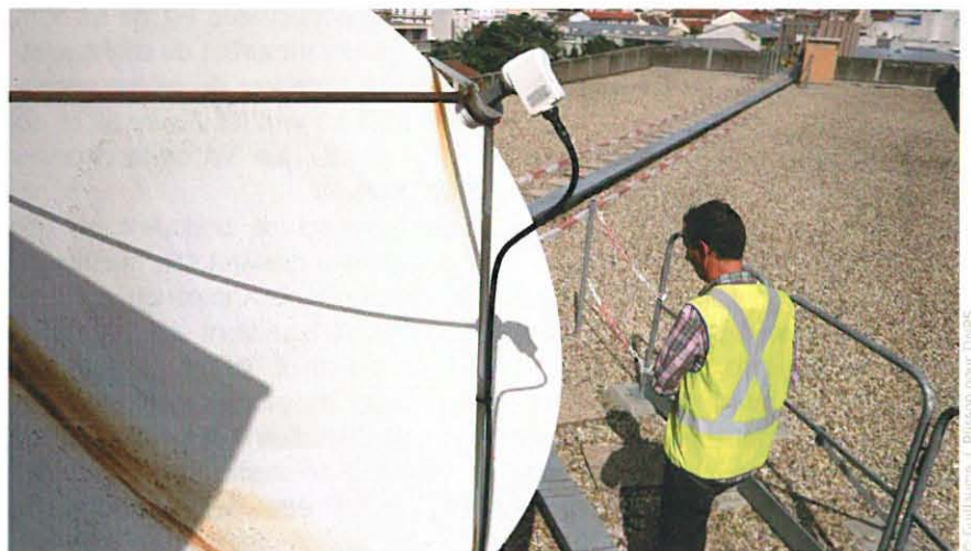
↑ Lors des travaux à réaliser près d'une parabole, les intervenants peuvent être exposés à des ondes électromagnétiques.
