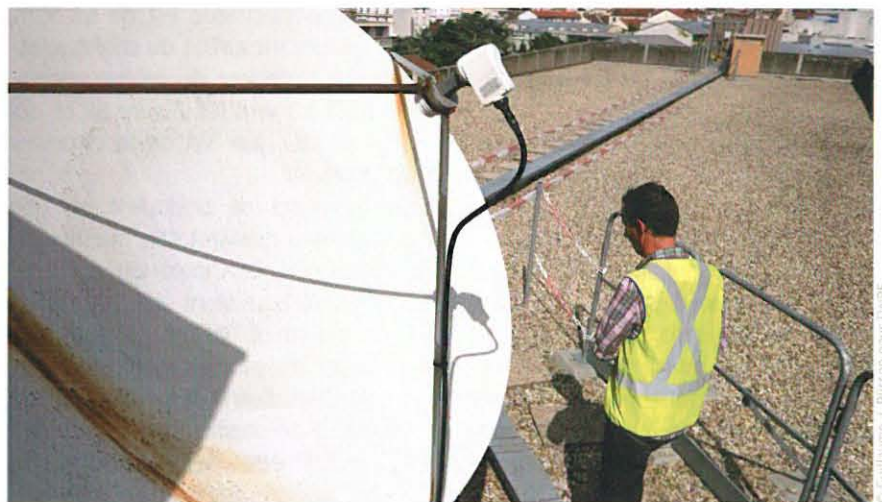
↑ Lors des travaux à réaliser près d'une parabole, les intervenants peuvent être exposés à des ondes électromagnétiques.
