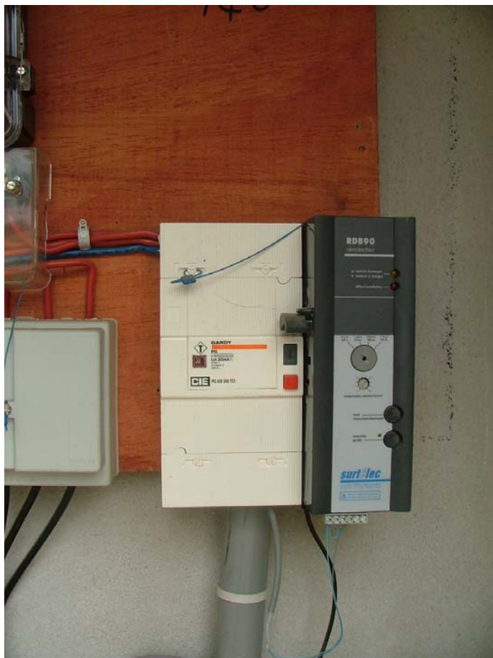
Disjoncteur à réarmement automatique
