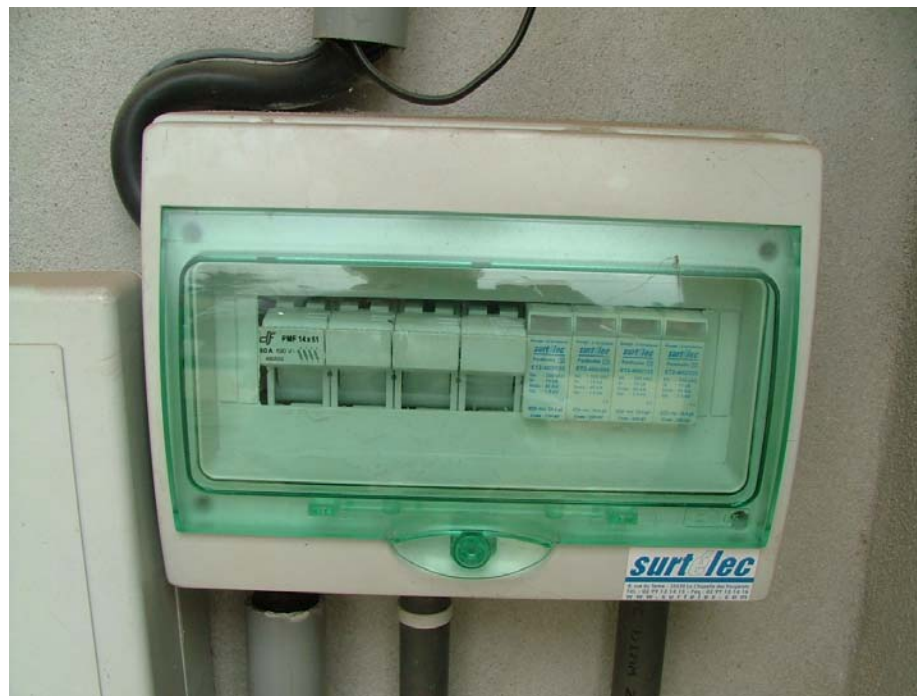
Parasurtenseurs en entrée d'énergie
